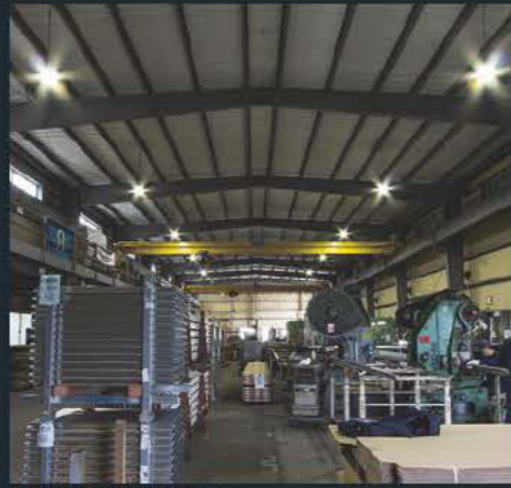
■ 高天井用LED照明 桐井製作所・茨城工場様 (茨城県)
