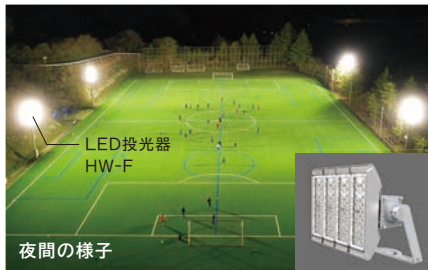
夜間の様子 ナイター照明は、LED投光器HW-Fを設置。夜間でも明るく、仕事終わりの社会人なども練習できるようになっています。
