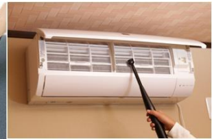
エアコンのフィルター
